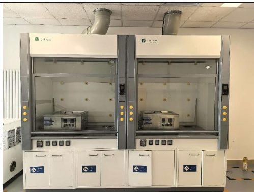
图 3-2 排气筒 DA010 通风橱
