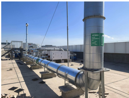
废气排放口标志牌
